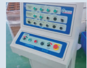
Tủ điều khiển
