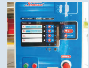
Tủ điều khiển
