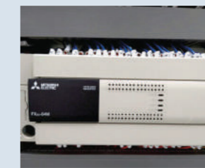
Hệ thống điều khiển PLC
